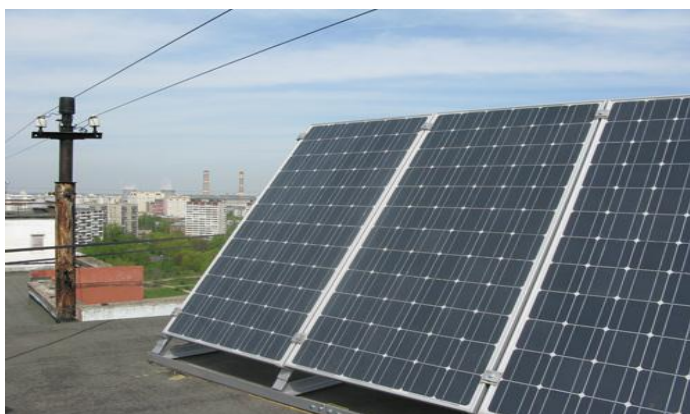
Рисунок 1 – Солнечные коллекторы на крыше машиностроительного цеха
